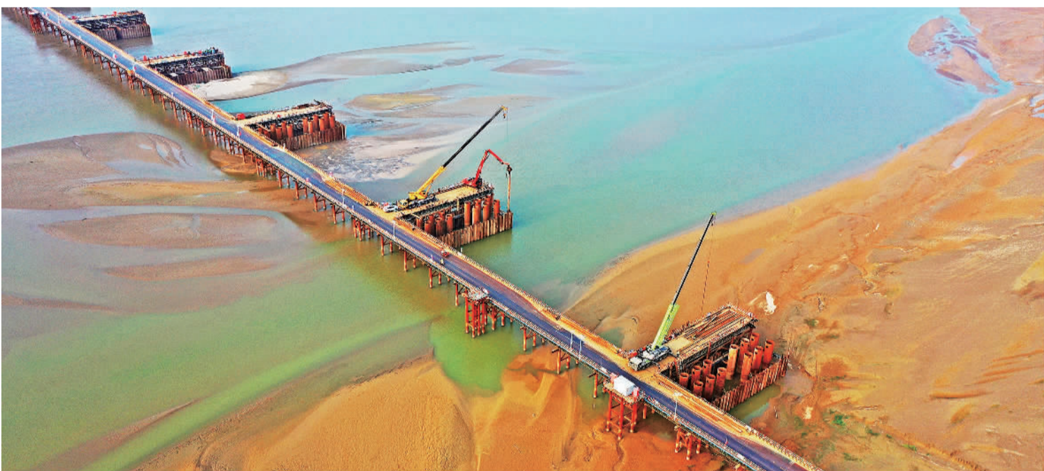
9月8日,河南沁伊高速五州黄河特大桥项目建设现场,施工单位正在进行桩基作业。沁伊高速是河南省“十四五”规划及“13445”工程重要项目,路线总长98.987公里,计划2025年12月建成通车。白水平摄(中经视觉)
