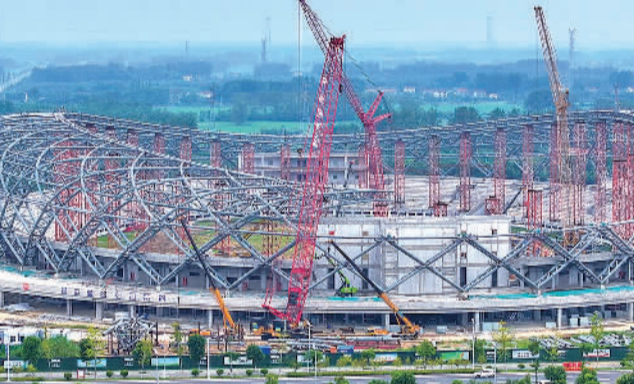
9月3日，江苏淮安金湖县体育产业商务运营中心工地，施工队正在进行钢结构吊装、焊接作业。该项目建成后，将成为当地集文化娱乐、体育竞技、商贸会议于一体的大型文化体育商务运营平台，可增加200个就业岗位。
