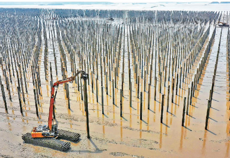
8月14日，浙江省温岭市东部松门渔光互补光伏电站项目建设现场，工人将预制桩压入滩涂。该光伏电站是温岭市南海涂70万千瓦容量滩涂渔光互补项目的一期工程。项目全部完工后，将成为全国规模最大的滩涂光伏电站，年发电量预计达7亿千瓦时。刘振清摄（中经视觉）
