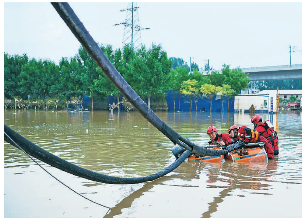
连日来，河北涿州等地强降雨引发严重地区进行排涝作业。
