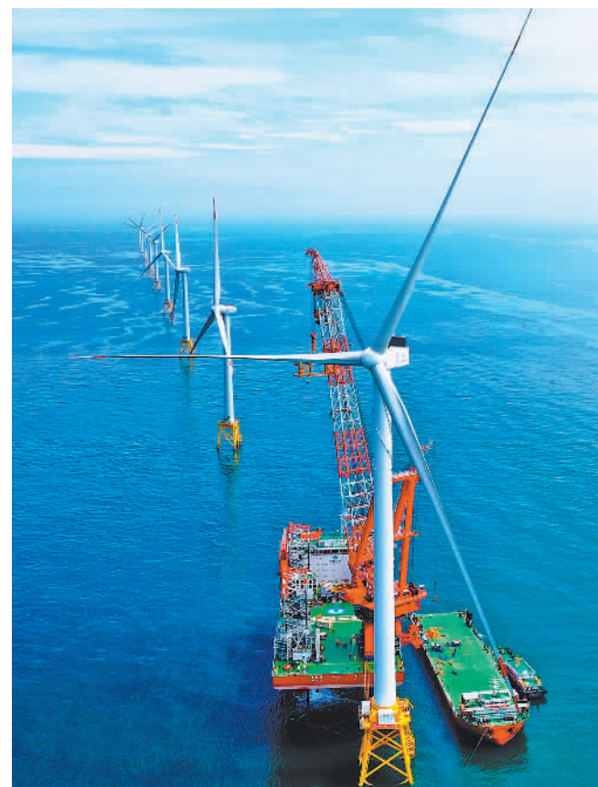
7月19日,16兆瓦超大容量海上风电机组在三峡集团福建海上风电场并网发电,标志着我国相关研发制造及运营能力再上新台阶。这是风电机组安装完成现场。新华社记者 林善摄
