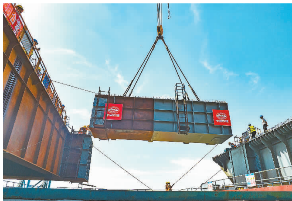
6月8日，随着最后一段钢主梁吊装到位，湖北省襄阳北编组站大桥顺利合龙。襄阳北编组站大桥共跨越32股铁路线，是国内跨越铁路线最多的混合梁斜拉桥。大桥建成后有效解决襄阳市被铁路东西分割造成交通拥堵的困扰。金伟摄(中经视觉)
