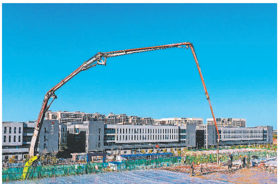
5月25日,在江西鹰潭高新区新能源锂电池产业园项目建设现场,工人们正在进行标准厂房及配套基础设施建设。据了解,该项目总投资100亿元,建设年产4GWh磷酸铁锂电池项目,将助力当地培育新能源产业链。
