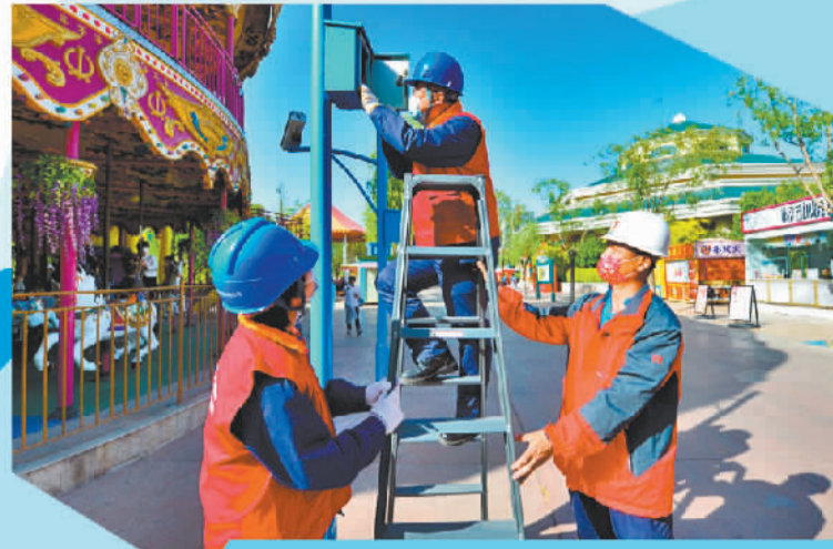
张黎明(中)带领滨海黎明服务队队员开展用电设备隐患排查。李婷摄(中经视觉)
