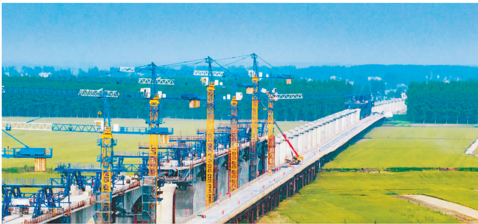
4月20日，中铁十一局建设者正在进行沪渝蓉高铁钟祥汉江特大桥施工。当日，大桥主墩承台全部完工。
