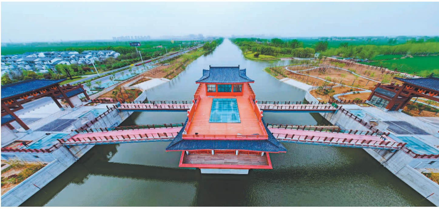
4月15日，江苏宿迁市泗阳县古汴河石集段活水工程正加紧施工。该工程将牌坊、桥、水闸、博物馆用船舫形式充分结合，让游客在欣赏古汴河风光带优美风景的同时，通过水情博物馆了解历史悠久的水文化。
