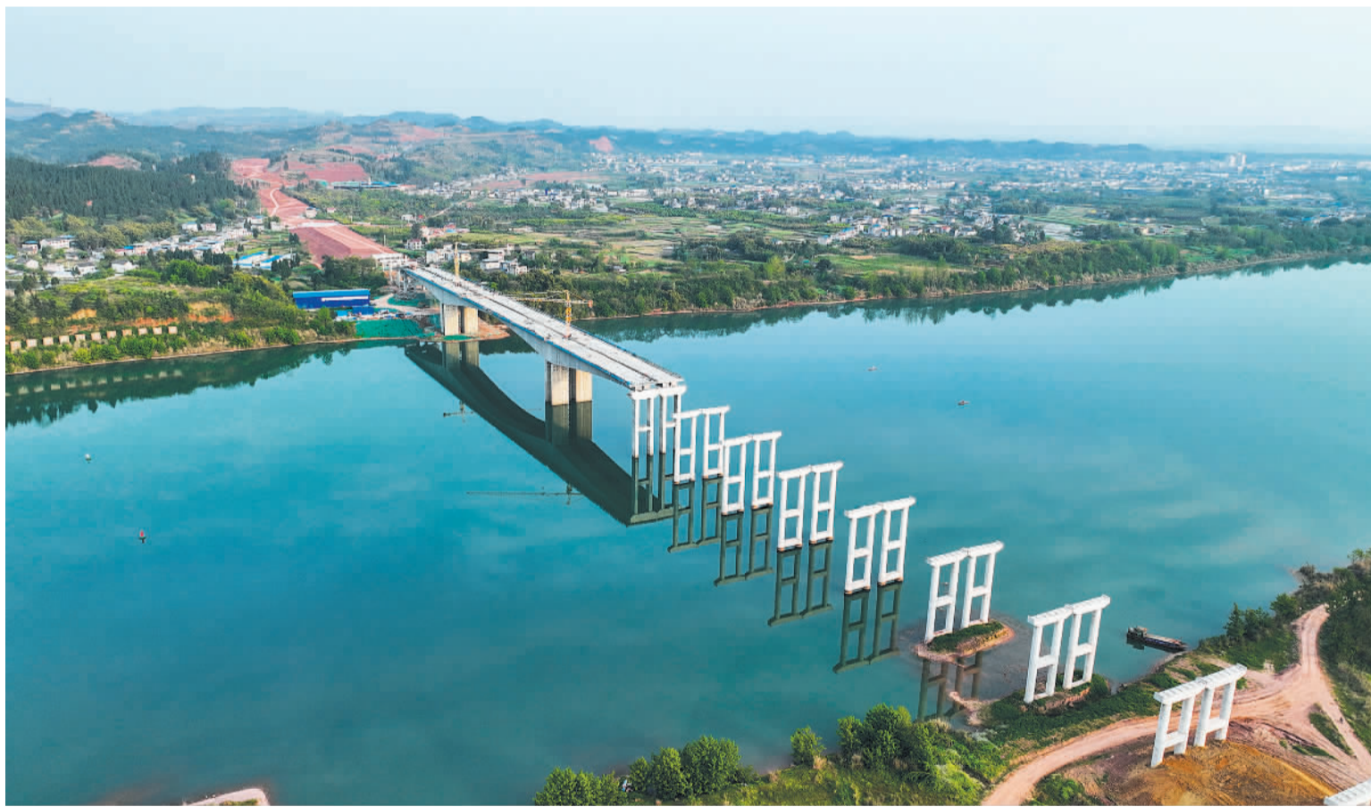
4月9日,位于四川省南充市的嘉陵江特大桥工程建设正酣,目前已完成超90%的工程量,即将进入架梁阶段。嘉陵江特大桥全长1057米,是南充过境高速(东北段)控制性工程,对南充融入成渝地区双城经济圈、拓展城市空间、分流过境车辆等具有重要意义。黎涛摄(中经视觉)
