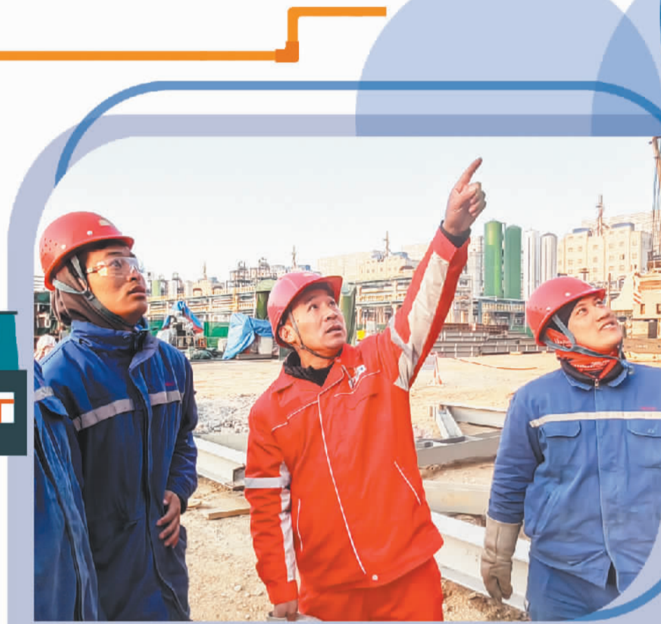
魏春涛(右二)与同事在现场就吊装方案进行交流。 丁禹晨摄(中经视觉)
