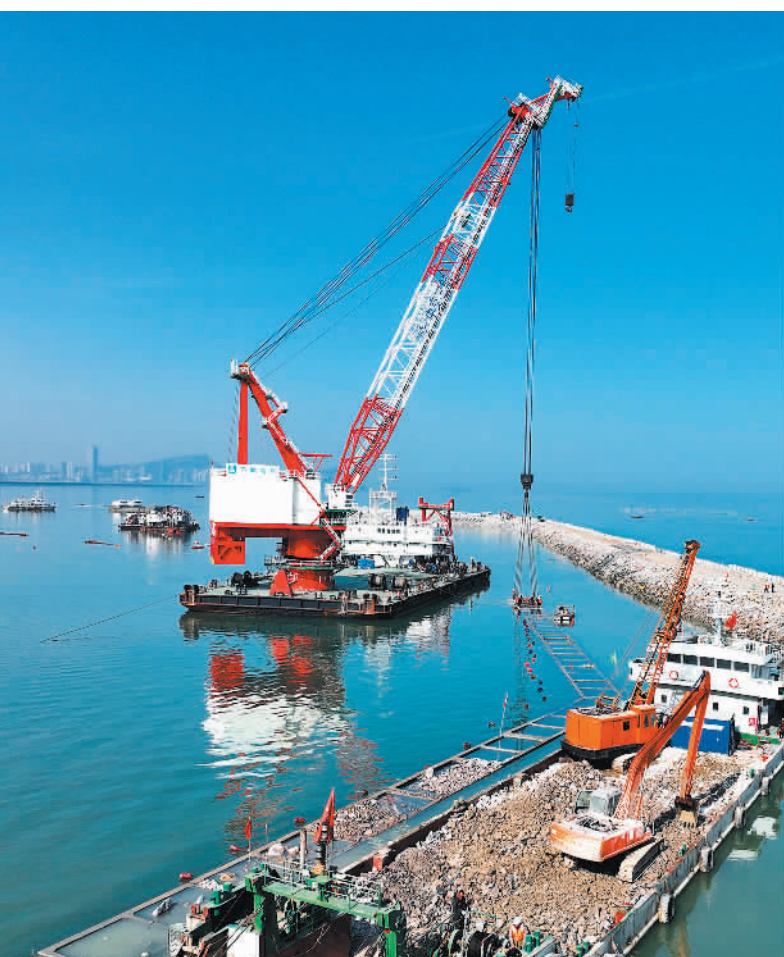
3月30日，江苏省连云港市连岛国家级中心渔港施工现场。中心渔港项目总投资约3.1亿元，预计全部工程将于年底完成，建成后可满足800艘以上渔船停泊装卸作业和补给需求，鱼货卸港量可达8万吨，将有效改善渔港作业环境，带动鱼货交易、渔业加工、渔船补给、渔业休闲等产业发展。
