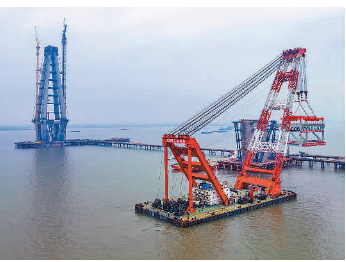
拉桥—道新钢梁架设在桥面展开(上接第一版) 三月二十日 周茂华认为，国内货币政策有望在保持总量适度增长的同时，引导信贷资金精准流向重点领域，提升政策实施效率，让政策更好平衡内外，兼顾短期和长期。 江苏省泰州市黄桥关深大桥主航 将成为世界上跨度最大的钢 汤德宏建成后 航主桥主跨 中经视觉
