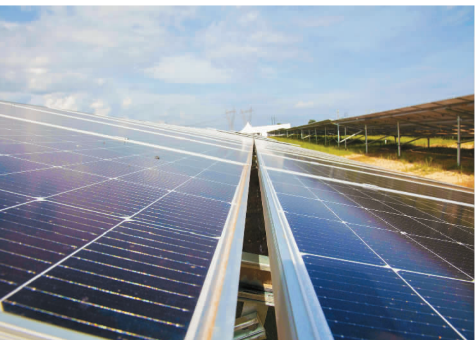
由中国水电建设集团国际工程有限公司承建的赞比亚光伏电站扩建项目2月15日在赞比亚铜省基特韦市并网发电。图为位于赞比亚铜省基特韦市的光伏电站。(新华社发)
