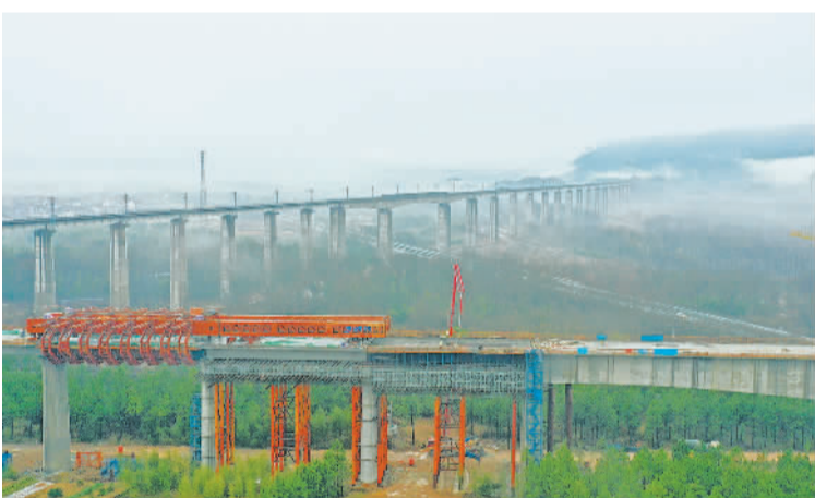
1月14日,浙江省杭州市杭甬铁路仙居特大桥顺利贯通。该特大桥是杭甬铁路重点控制性工程,桥梁总长4418.33米。图为中铁上海工程局建设者正在该项目加紧施工。 王华斌摄(中经视觉)
