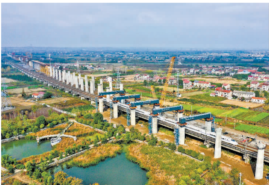
11月22日,新建湖北荆(门)至荆(州)高铁江汉运河2号特大桥5处跨(武)汉宜(昌)铁路钢梁施工全部完成。荆荆高铁全长约77公里,设计时速350公里,是我国“八纵八横”高速铁路网中呼(和浩特)南(宁)高铁双通道的重要组成部分。徐云华摄(中经视觉)
