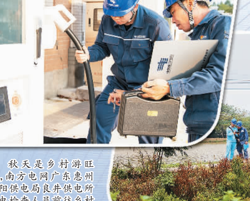
秋天是乡村旅游旺季，南方电网广东惠州惠阳供电局良井供电所用电检查人员前往乡村旅游胜地附近充电桩开展安全用电检查
