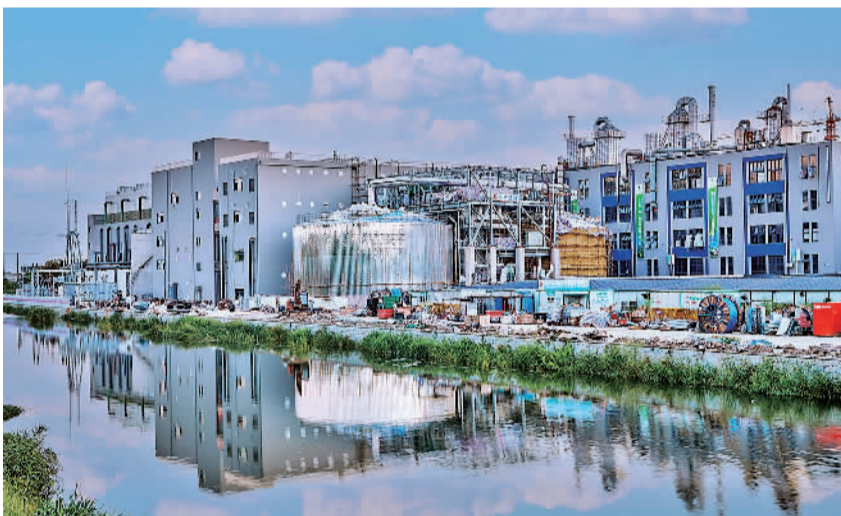
9月20日，位于绍兴天实产业园的浙江省最大绿电熔盐储能项目施工进入扫尾阶段。该项目投运后，每年可发电3200万千瓦时，年供蒸汽量42万吨，全年节约动力煤13.9万吨，助力企业实现绿色低碳转型。孟永平摄(中经视觉)
