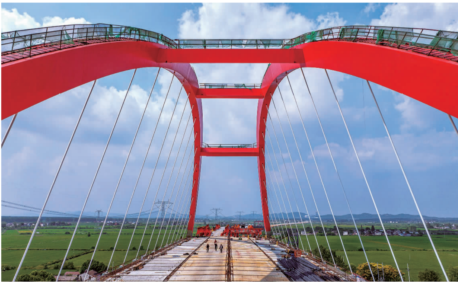
9月17日,安徽省合肥市庐江县盛桥镇境内的无(为)岳(西)高速兆河特大桥施工现场,建设者坚守岗位确保施工进度。兆河特大桥是沪武高速无为至岳岳县段的重要节点工程。大桥全长2402米,建成后将进一步促进区域经济发展。左学长摄(中经视觉)
