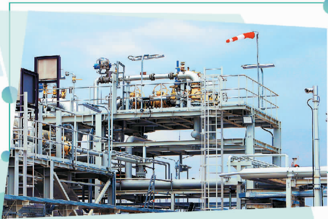
图为罗马尼亚康斯坦察县瓦杜村的天然气处理站。(新华社发)
