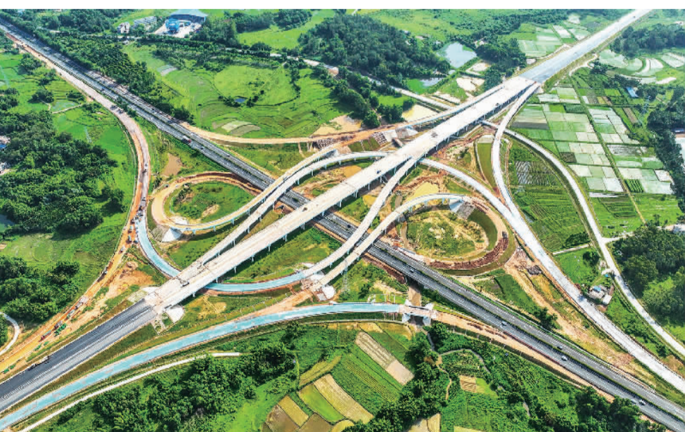
7月16日,建设中的海南文临高速公路定安美玉互通路段。文临公路作为海南“丰”字形高速公路网中的第一横,全长121.36公里。目前项目全线正加快建设,预计将于今年年底建成通车,将大大缩短临高与海南东北部市县的通行时间。张茂摄(中经视觉)
