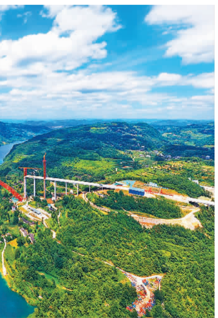
7月12日，位于贵州省铜仁市与遵义市交界处的德余高速乌江特大桥正在紧张建设中。该大桥位于贵州凤冈县、思南县、石阡县三地交界处，预计今年8月中旬完成合龙。
