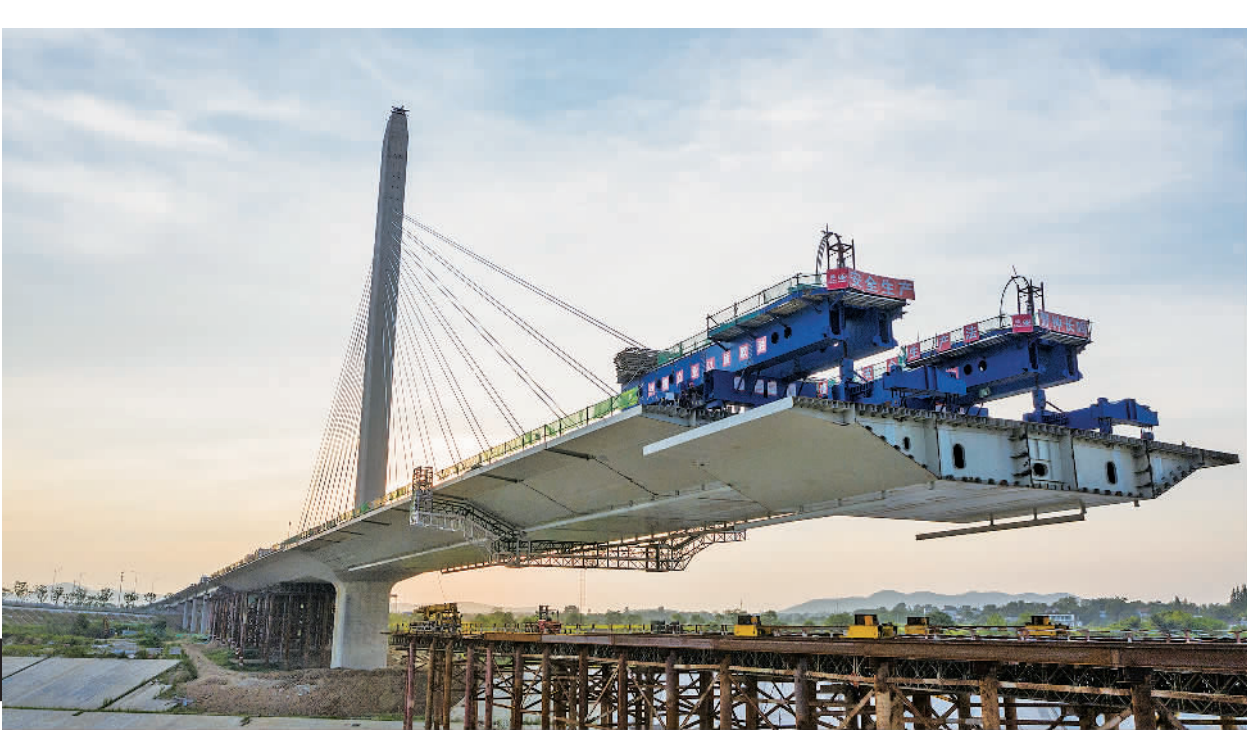
7月12日,施工人员在安徽省合肥市庐江县万山镇岳武高速东延项目跨引江济淮工程罗埠河特大桥进行钢箱梁吊装施工作业。岳(西)武(汉)高速东延项目是上海至武汉高速公路(G425)和安徽省高速公路网的重要组成部分,项目起于北沿江高速无为市石涧枢纽,终于岳西县北枢纽,全长178公里,计划于2023年年底建成通车。柳晓华摄(中经视觉)
