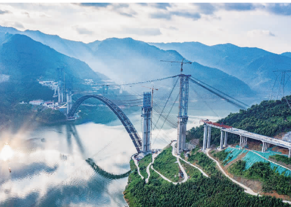
6月26日,建设中的广西河池市天峨龙滩特大桥。该大桥全长2488.55米,其中,主桥采用上承式动性骨架混凝土拱桥方案,跨径600米,建成后将成为世界最大的跨径拱桥,实现天峨县高速公路全线贯通,推动当地经济社会发展。 周思军摄(中经视觉)
