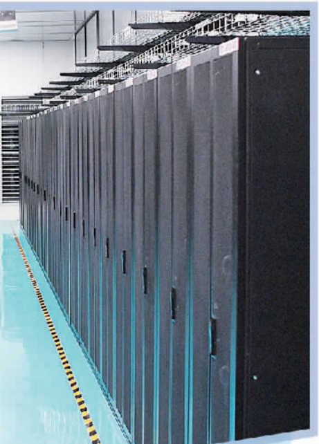
由中国联通建设的国家(中卫)新型互联网交换中心机房。宁夏近日出台了关于促进大数据产业发展应用的实施意见,打造面向全国的算力保障基地。 新华社记者 王 鹏 摄
