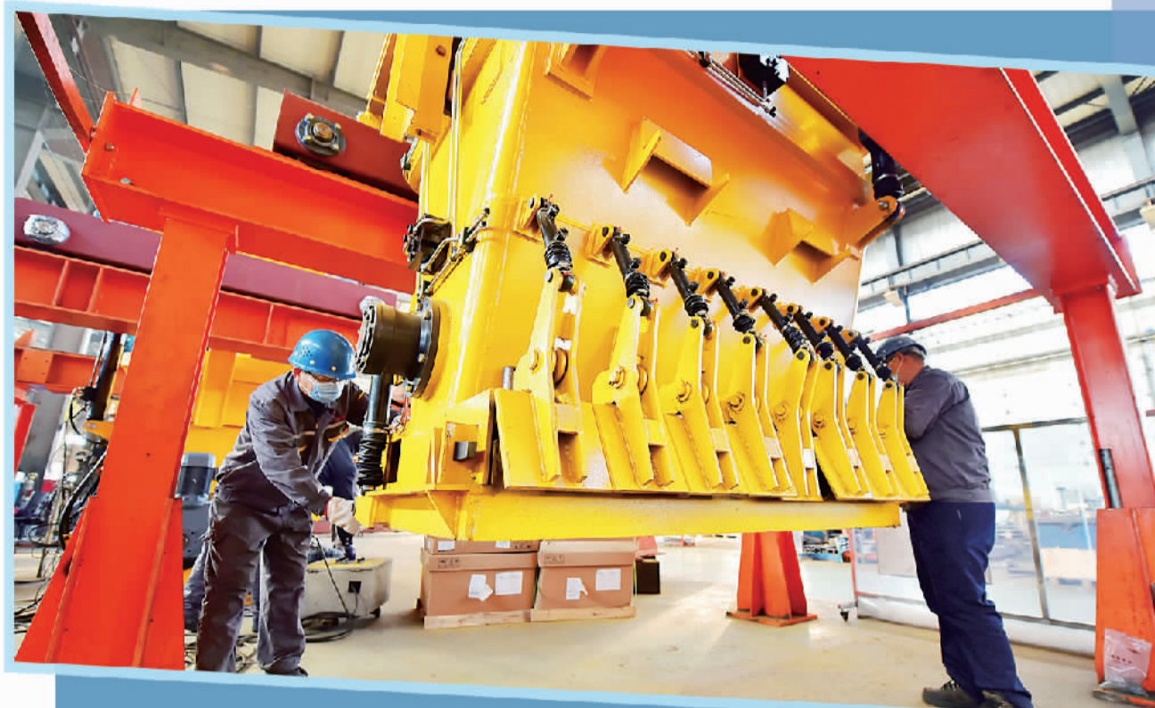
在河北石家庄市正定县国家专精特新“小巨人”企业河北新大地机电制造有限公司生产线上,工人正在安装设备。 张雪峰摄(中经视觉)
