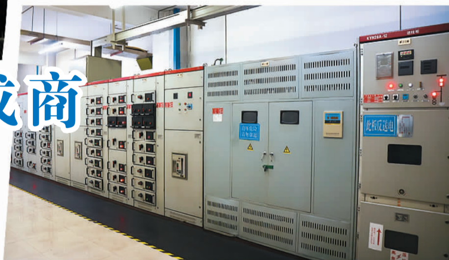
山东能源鲁西矿业新巨龙能源智能化无人值守水源热泵机房
