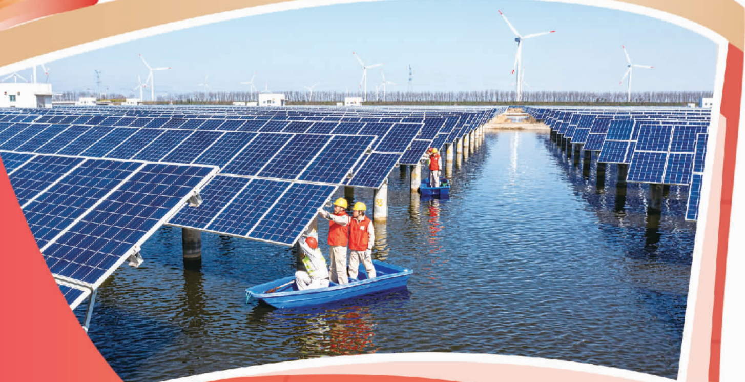
在江苏省淮安市海新区,电力工人巡检光伏发电设施。
