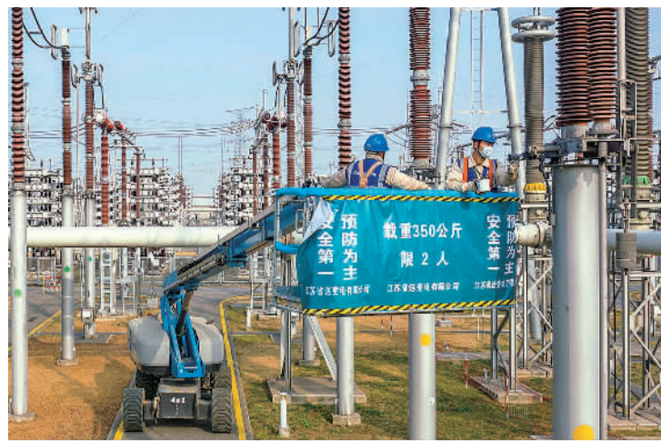
在±800千伏特高压苏州换流站检修现场,江苏省送变电有限公司施工人员正在对全站设备及辅助系统进行全面检修。史俊摄(中经视觉)
