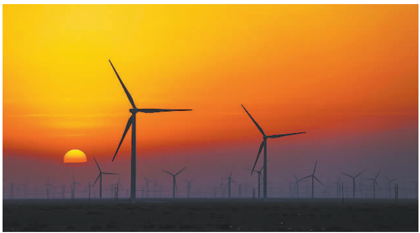
1月20日,夕阳下的甘肃省瓜州县风力发电塔成为戈壁上一道亮丽风景。近年来,瓜州县依托区域资源优势,积极推进风电项目建设,让茫茫戈壁成为“聚宝盆”。
