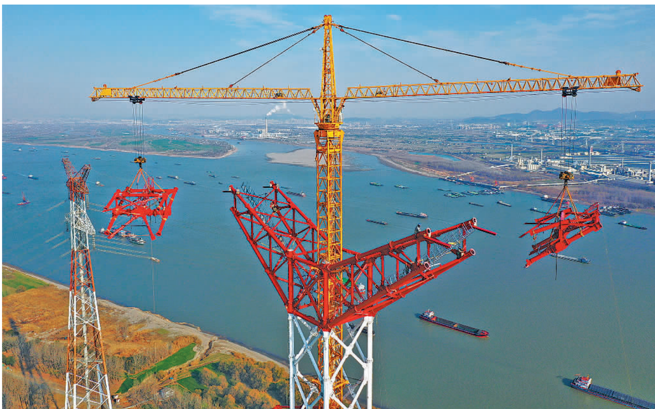
12月26日,长江大跨越输电钢管塔封顶施工现场。当日,位于安徽马鞍山长江边的白鹤滩—江苏±800千伏特高压直流输电工程长江大跨越输电钢管塔封顶。工程投运后每年输送电力将超过312亿千瓦时。 赵献富摄(新华社发)
