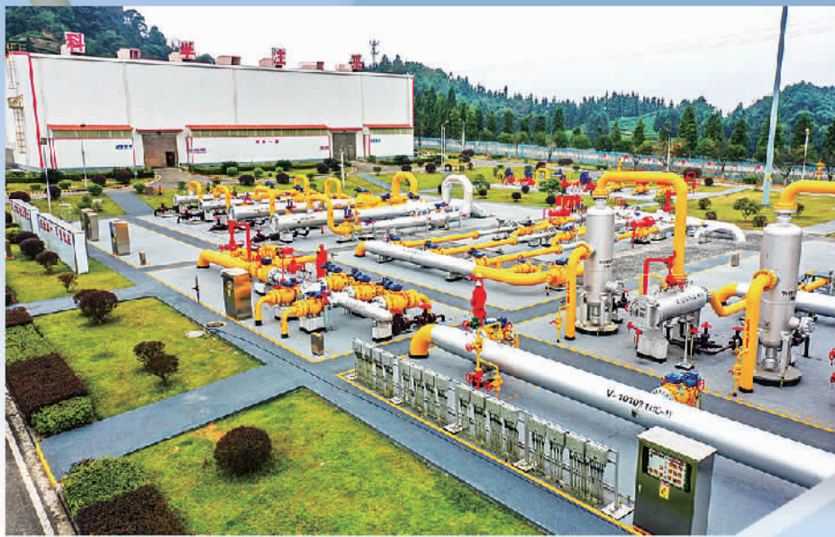
中国石油西南油气田公司相国寺储气库工作人员对集输区设备进行安全巡检。 新华社记者 黄伟摄
