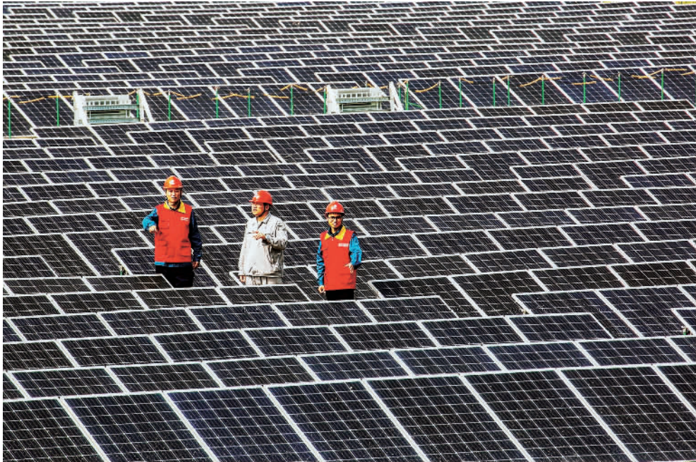
11月16日,国家电网公司工作人员在山东华能济宁高新区光伏电站进行安全检查。近年来,济宁加快建设鲁西南采煤塌陷地光伏发电基地,风电、光伏装机规模不断扩大。预计到年底,全市新能源装机将达260万千瓦,发电量将达35亿千瓦时,可替代标煤105万吨。
