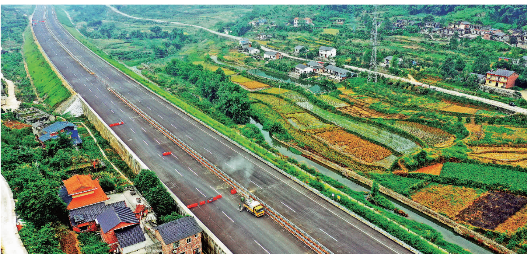
10月28日,渝黔高速公路扩能项目(万盛南桐营寨段)施工现场,工人正在为道路施划标识标线。渝黔高速公路全线建成贯通后,将极大改善既有渝黔高速的拥堵状况,形成重庆高速公路网南北主轴的重要通道与向南经贵州直达广西的出海高速通道。王庐州摄(中经视觉)
