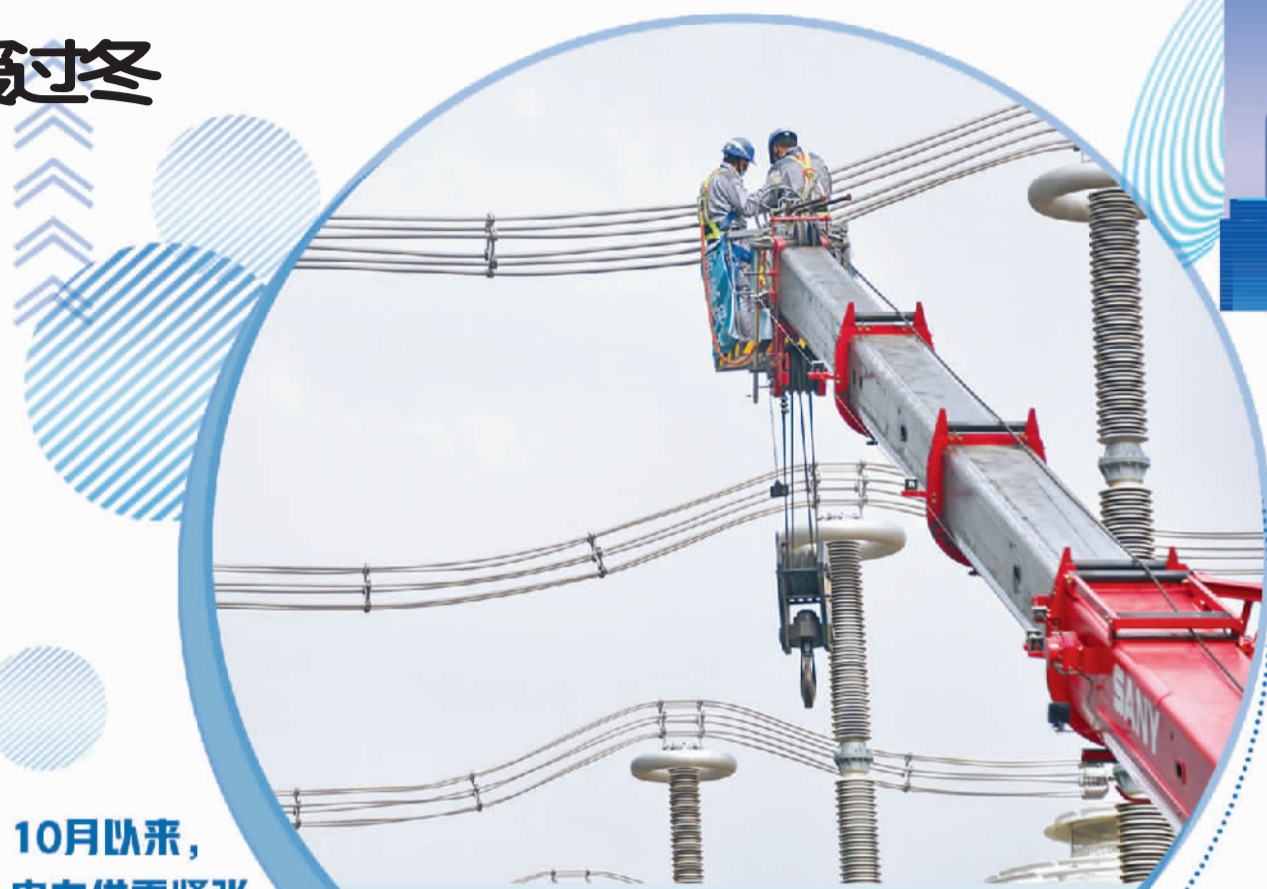
9月25日,国网北京市电力公司延庆换流站的员工在检查输电设备。
