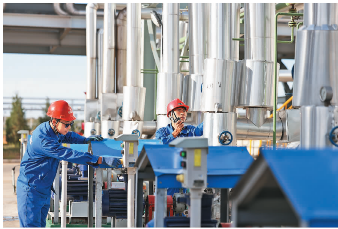
工作人员在位于陕西省榆林市榆阳区的陕西未来能源化工有限公司10万吨/年费托蜡精加工项目检修。该项目产出的115℃高熔点蜡为国内最高熔点的高端费托蜡新产品,打破了国外垄断。本报记者 高兴撰
