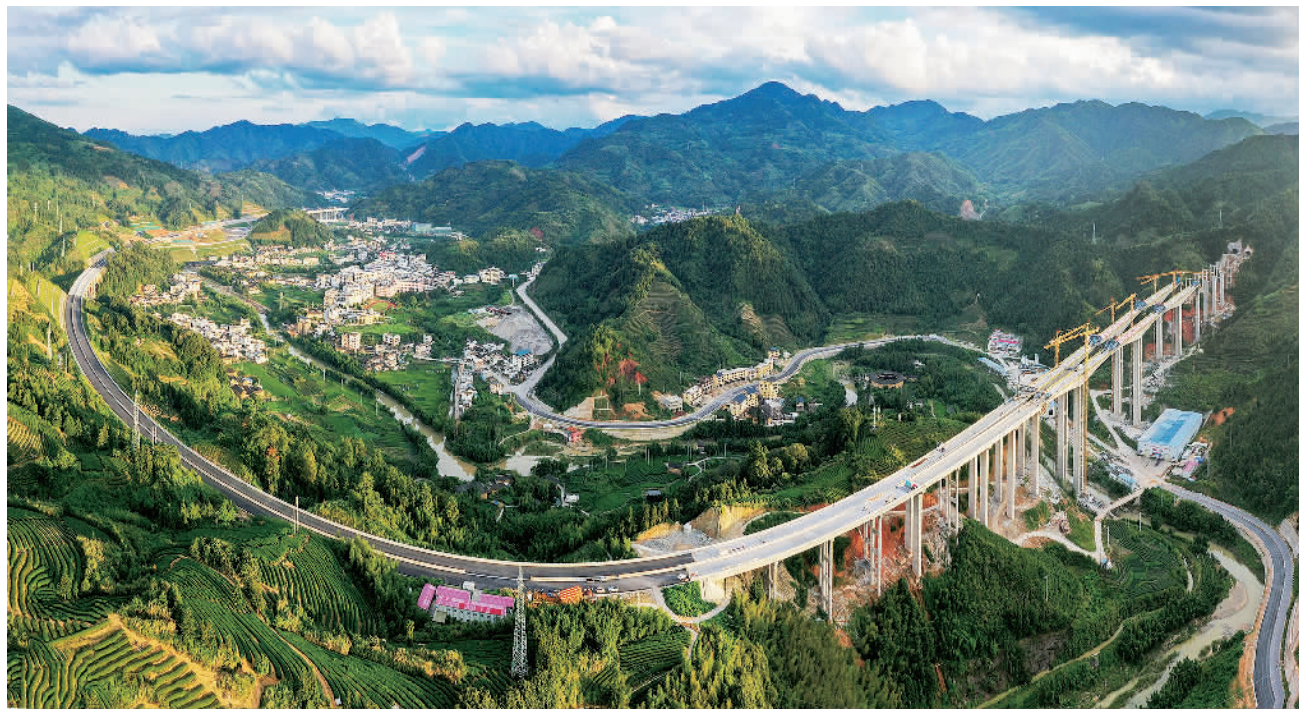
8月24日,由中铁十六局集团承建漳(州)武(平)高速公路重难点及控制性工程——书洋特大桥主桥顺利合龙。这是漳武高速首座合龙的大跨度桥梁。书洋特大桥采用双向四车道高速公路标准,设计时速100公里,全长1074米。许鹏摄(中经视觉)
