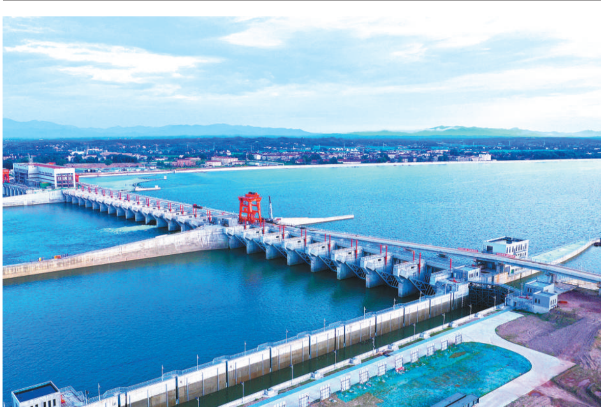
8月18日，俯瞰建设中的江西赣江井冈山航电枢纽工程。该工程水电站总装机133兆瓦，年均发电量5亿千瓦时，可每年节约标准煤约6万吨，减少烟尘排放量约1万吨。
