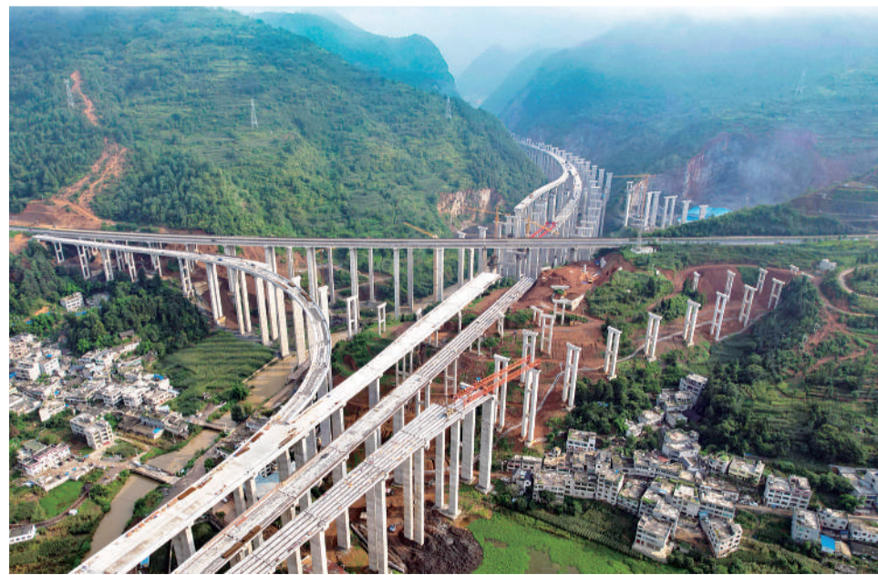
8月8日,建设中的宜宾至六盘水高速公路赫章东互通。宜宾至六盘水高速公路连接贵州、云南、四川3省的六盘水、毕节、昭通、宜宾4个市,对推进3省大通道建设具有重要意义。贵州境内的镇雄(滇黔界)至赫章段、赫章至六盘水段全长109公里,在赫章县野马川镇与毕成高速十字交叉形成赫章东互通。韩贤普摄(中经视觉)
