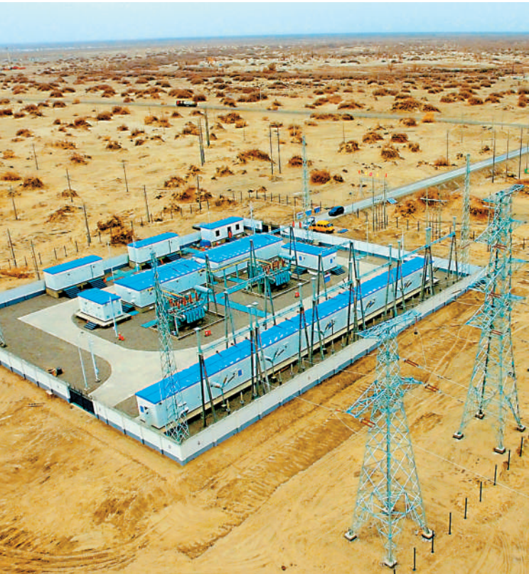
4月10日,在位于新疆库车市的塔克拉玛干沙漠北缘,中国石化西北油田110千伏塔河四区变电站成功投运。该工程是西北油田重点项目工程,变电站的投运将承担塔河电网70%以上的用电负荷,大幅优化塔河电网主网结构,解决外部电源支撑薄弱等问题。 谭 辉摄(中经视觉)
