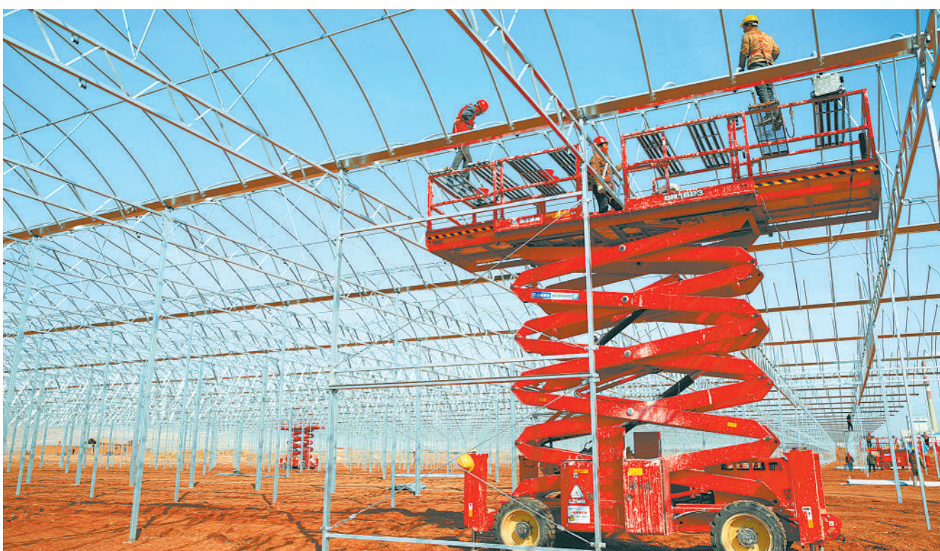
3月9日,甘肃省张掖市甘州区靖安乡现代农业示范园区,工人在即将建成的5万平方米现代智能温控大棚上安装、固定配套设施。
