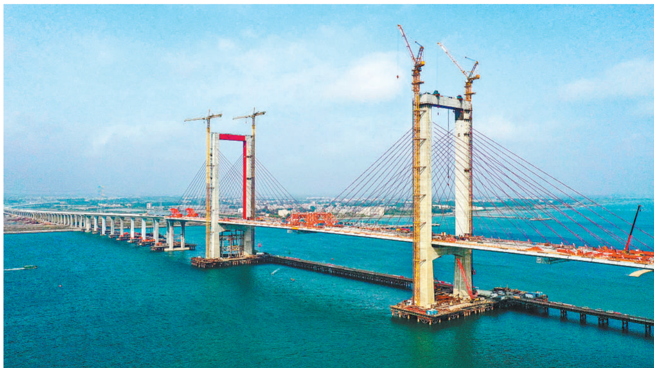
1月25日，由中铁大桥局承建的湛江调顺跨海大桥成功合龙。全长约9.36公里的调顺跨海大桥为广东省重点工程，跨越湛江湾连接湛江市调顺岛及海东新区，将对接粤港澳大湾区，对加快广东粤西片区经济发展发挥重要连通作用。 新华社记者 刘大伟摄
