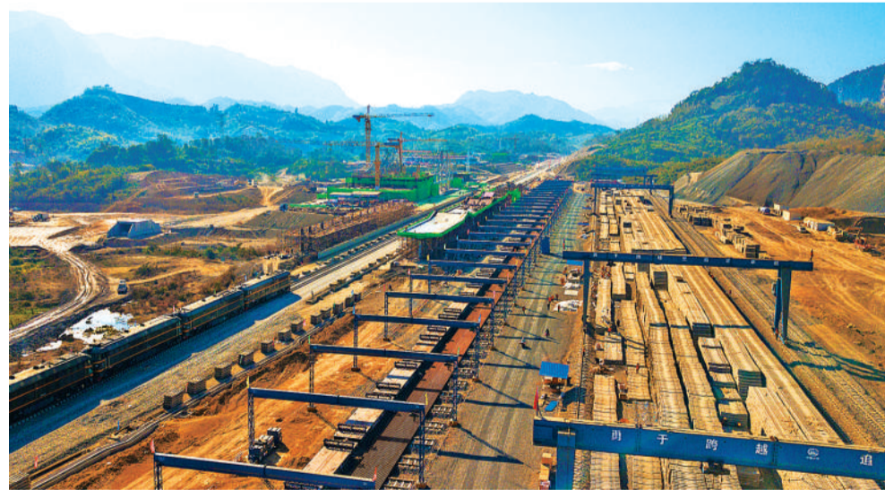
图为2020年12月29日在老挝琅勃拉邦拍摄的中老铁路琅勃拉邦车站铺轨现场。
