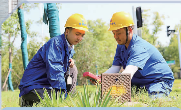
合肥市燃气公司工作人员在巡查巡检燃气管线。何建轩摄
