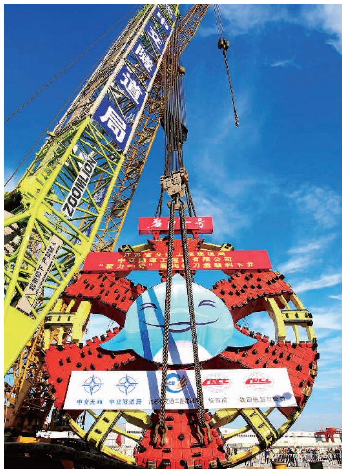
2月20日，中交隧道局工人在江苏靖江对江阴靖江长江隧道国内最大直径盾构机“聚力一号”刀盘进行吊装下井。刀盘涂装了“微笑天使”长江江豚标识，蕴含着该工程对长江生态保护的高标准要求。“聚力一号”将于4月底始发，进入掘进施工阶段。 汤德宏摄(中经视觉)
