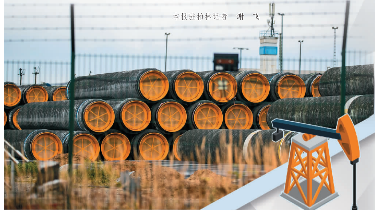
在德国萨斯尼茨实拍的“北溪2号”天然气管道。(资料图片)
