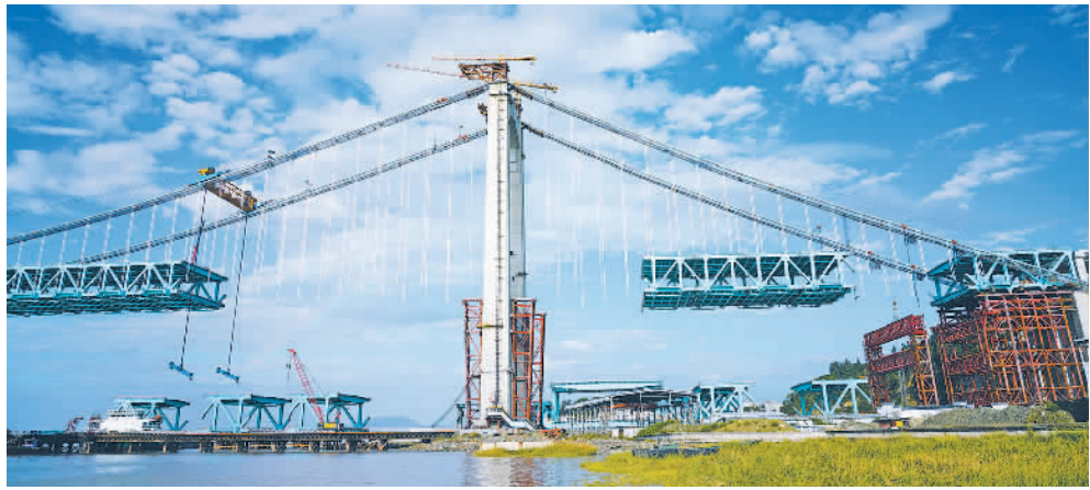
11月7日,浙江省温州市瓯江北口大桥正在垂直吊装加劲梁。瓯江北口大桥全长7.9公里,其中跨瓯江主桥长2090米,是世界首座三塔四跨双层钢桁梁悬索桥,预计今年年底全桥贯通。蔡宽元摄(中经视觉)
