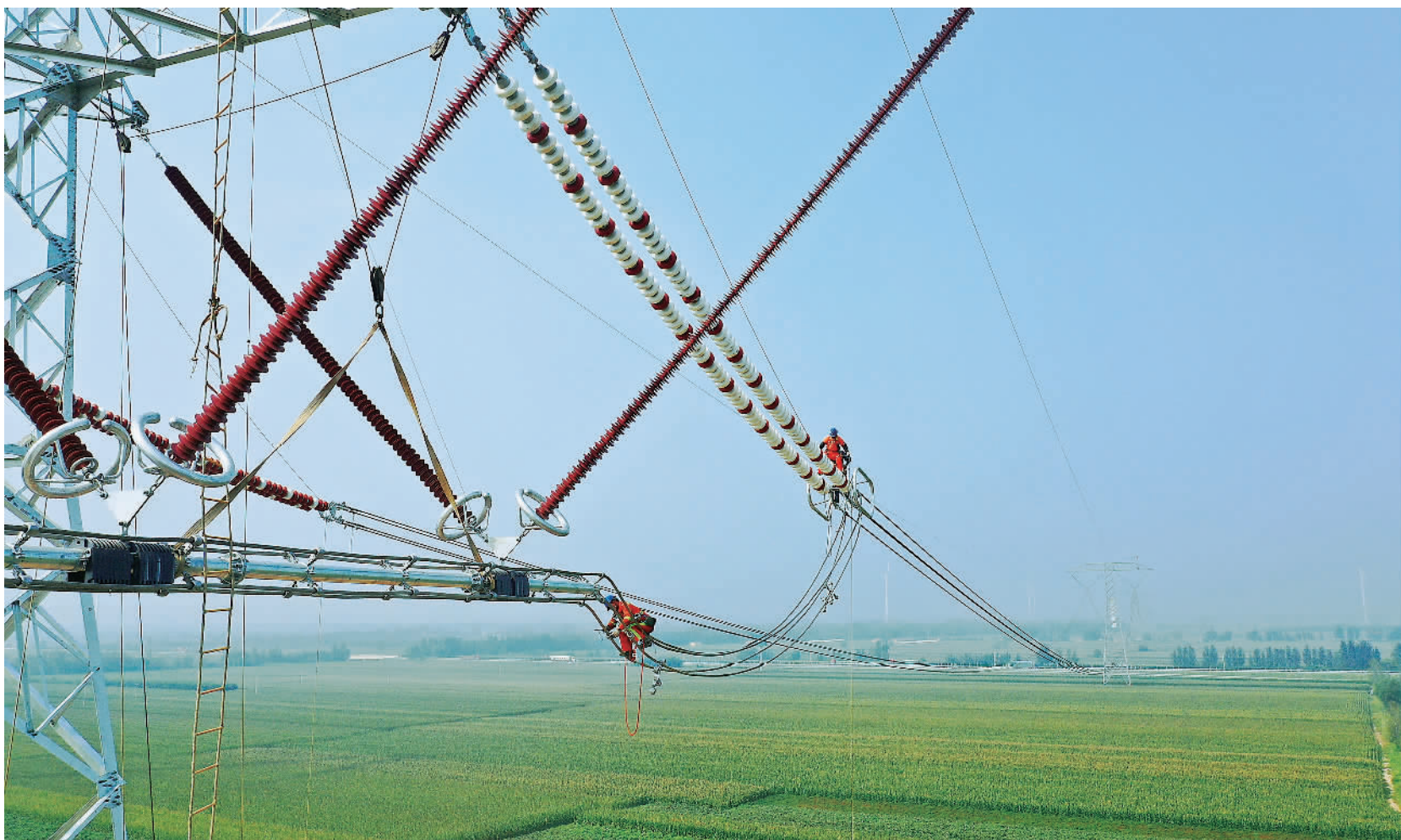
10月4日，国家电网属地化巡检人员对近日竣工的银东直流输电线路山东夏津1911号直线塔改耐张工程进行特巡作业。±660千伏银东直流输电工程是宁夏电力外送山东重要通道，是国家电网“西电东送”重点工程，目前工程已运行逾10年，累计输送电量超过3000亿千瓦时。随着工程进入第二个10年运营，国网开展大规模综合检修，全面完成对直流设备的“大体检”以及部分核心设备的整体更换，保障电力可靠供应。李海涛摄（中经视觉）
