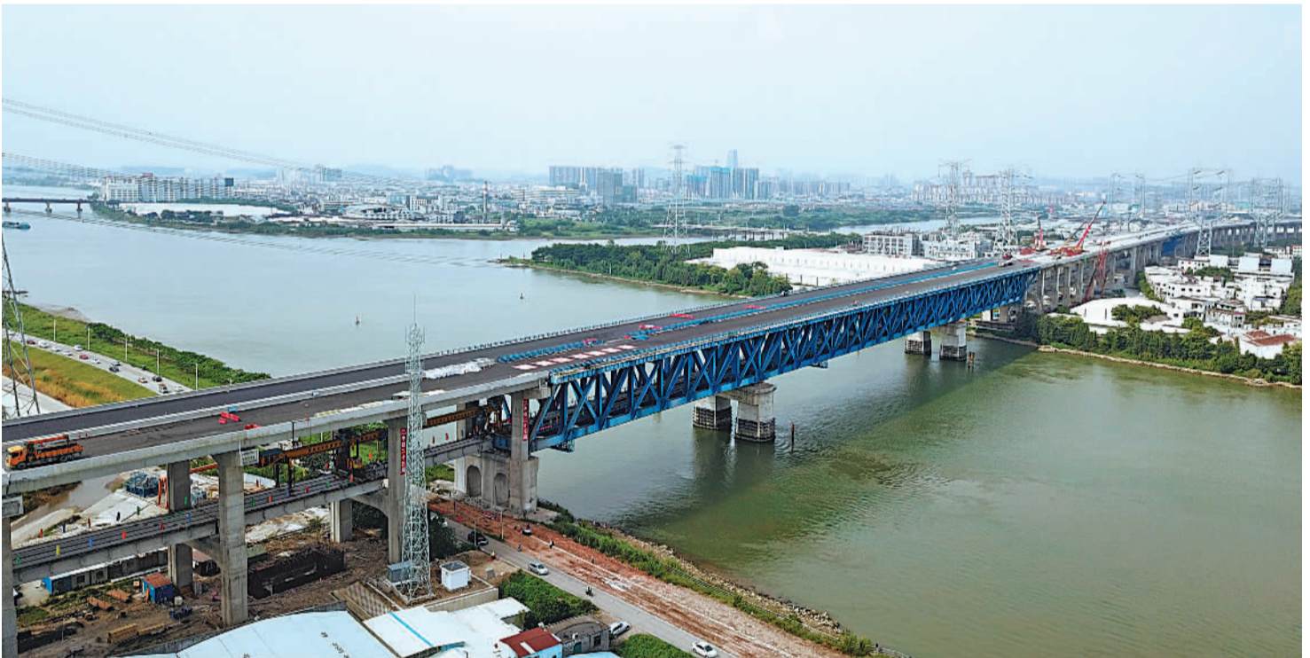
9月16日,在广东省中山市南头镇西江特大桥施工现场,随着中铁二十五局建设者将最后一块梁安装到位,南沙港铁路架梁施工任务圆满完成,标志着全线主体工程顺利完工。 南沙港铁路是珠三角西部重要组成部分,建成后打通公路、铁路和港口等立体运输网络,提升广州枢纽功能,促进粤港澳大湾区协同发展。 蔡如锦摄(中经视觉)
