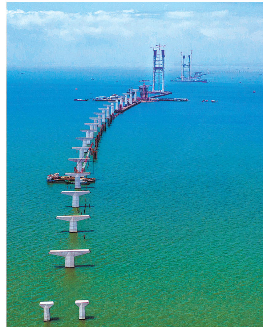
4月24日,深中通道正在如火如荼建设中,位于广东深圳区域的伶仃洋大桥主桥桩基、承台已完成,正在进行桥梁主塔、锚碇施工。(邱新生摄(中经视觉))
